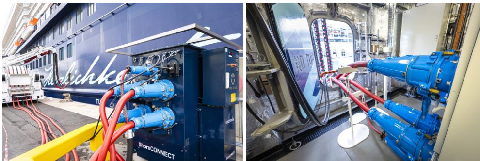
An der Steckdose: Gestern bezog die Mein Schiff 6 erstmals in Kiel Landstrom. Bereits im Mai hatte die Mein Schiff 4 (hier im Bild) einen Großteil der Tests absolviert und wird demnächst ebenfalls in Kiel an die Landstromanlage angeschlossen. Foto: TUI Cruises/ Ulrich Schaarschmidt
